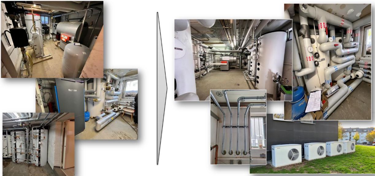
Abb. 3: Bestandsaufnahme der vorhandenen Situation (links) und fertiggestellte / ergänzte Heizungsanlage mit Wärmepumpe (rechts)
