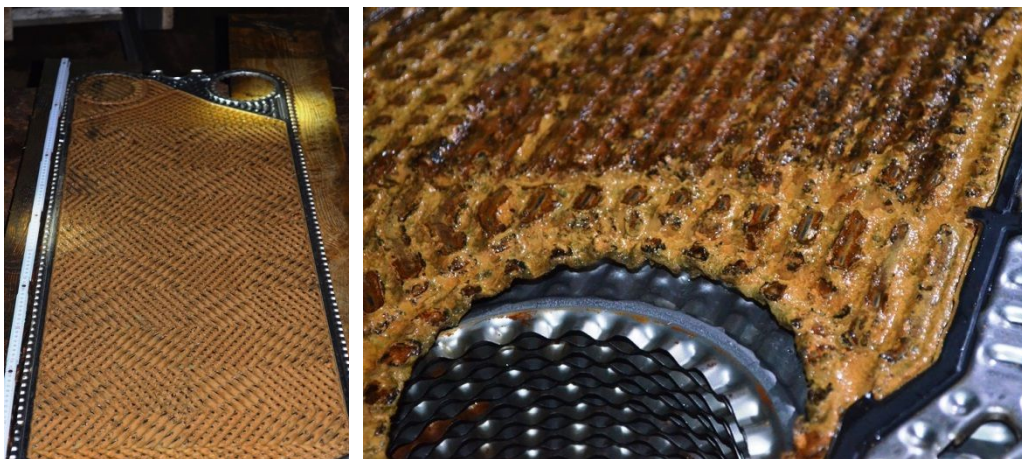
Abb. 5: Foulingrückstände auf Wärmeübertragerplatten vor mechanischer Reinigung
