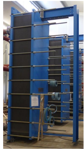
Abb. 3: Eingängige Wärmeübertrager im Einbauzustand.
