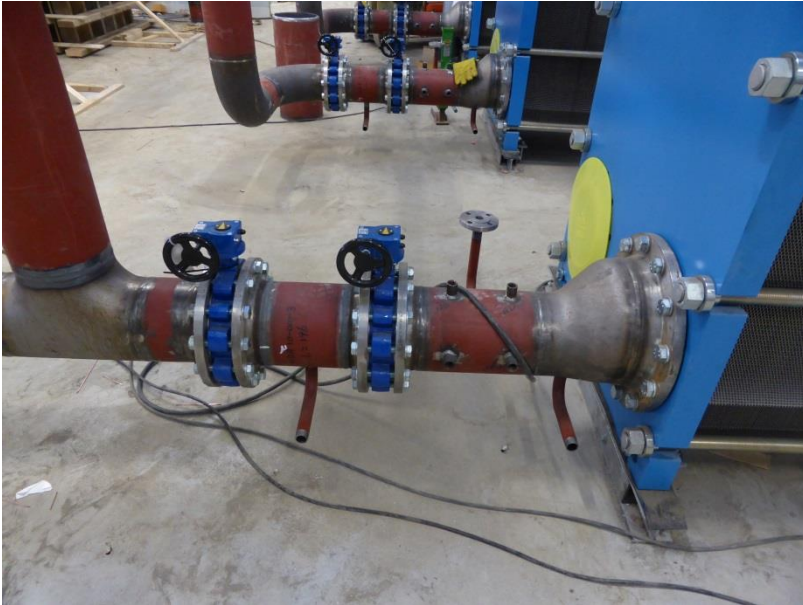
Abb. 4: Rohrleitungsanschlüsse der Wärmeübertrager, die alle auf einer Seite liegen, um Wartungsfreundlichkeit zu gewährleisten.
