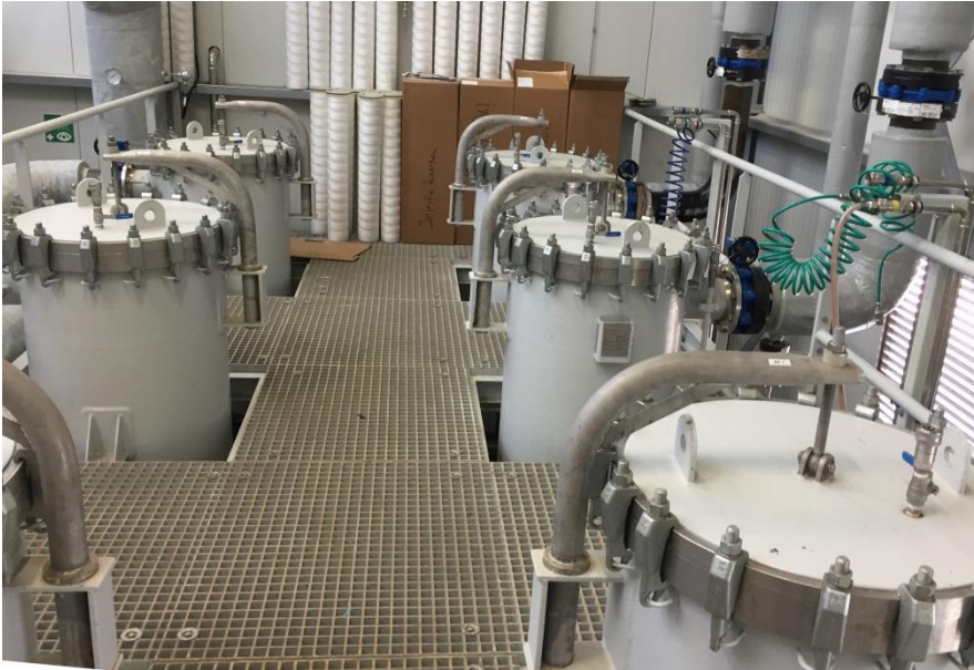
Abb. 6: Filtertribüne im Heizwerk mit den Kerzenfiltern
