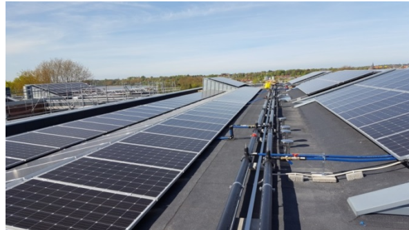
Abbildung 2: Dachabsorber unter PV-Anlage
