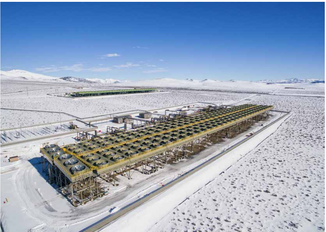
Der McGinness Hills Geothermal Complex ist ein Komplex von drei geothermischen Kraftwerken im Bundesstaat Nevada.
